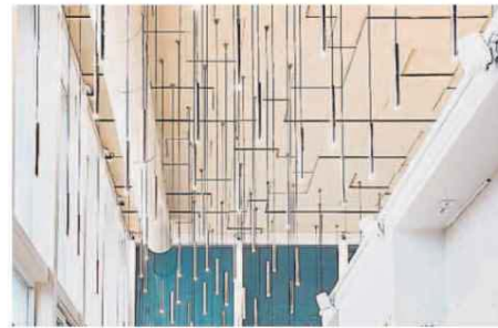
• Secciones suspendidas en el techo de lana de roca.
